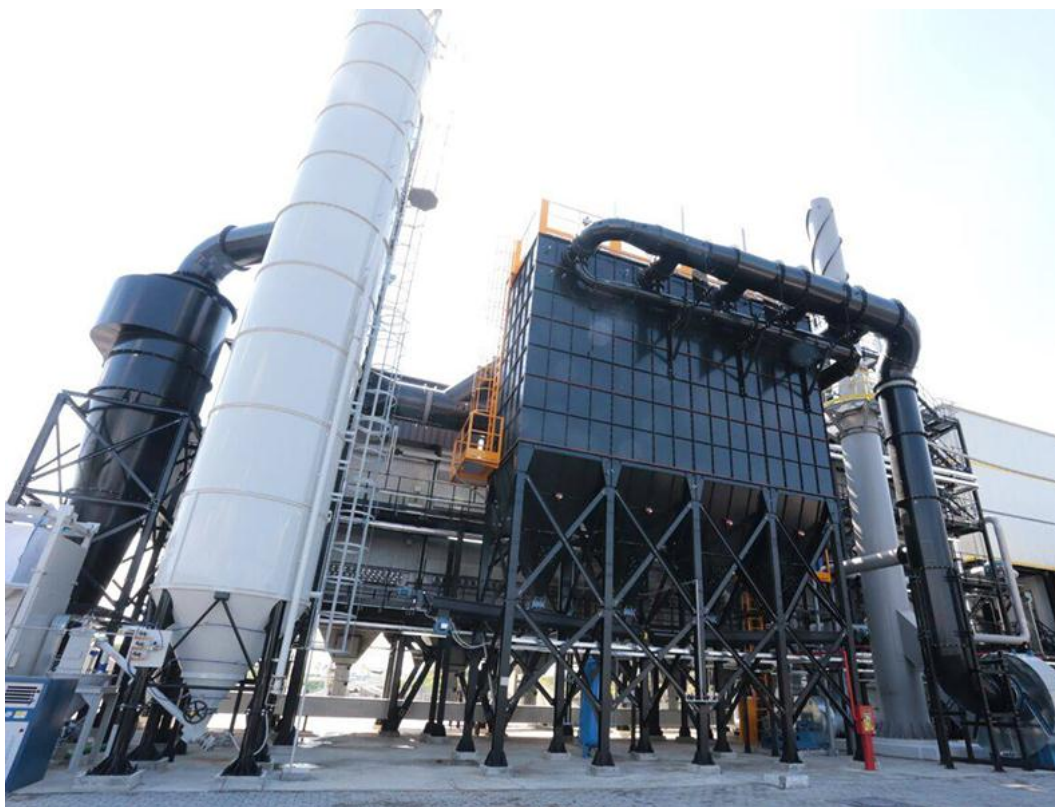
Fig. 7 17 Pamje e impiantit të prodhimit të energjisë Elbasan
